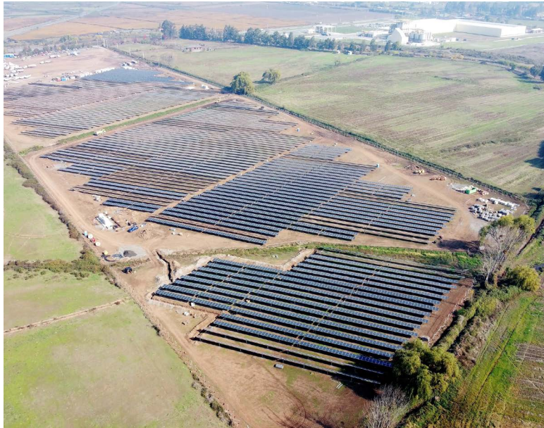
Planta fotovoltaica de 7,36 MW Milán, Región de Maule (Chile)
