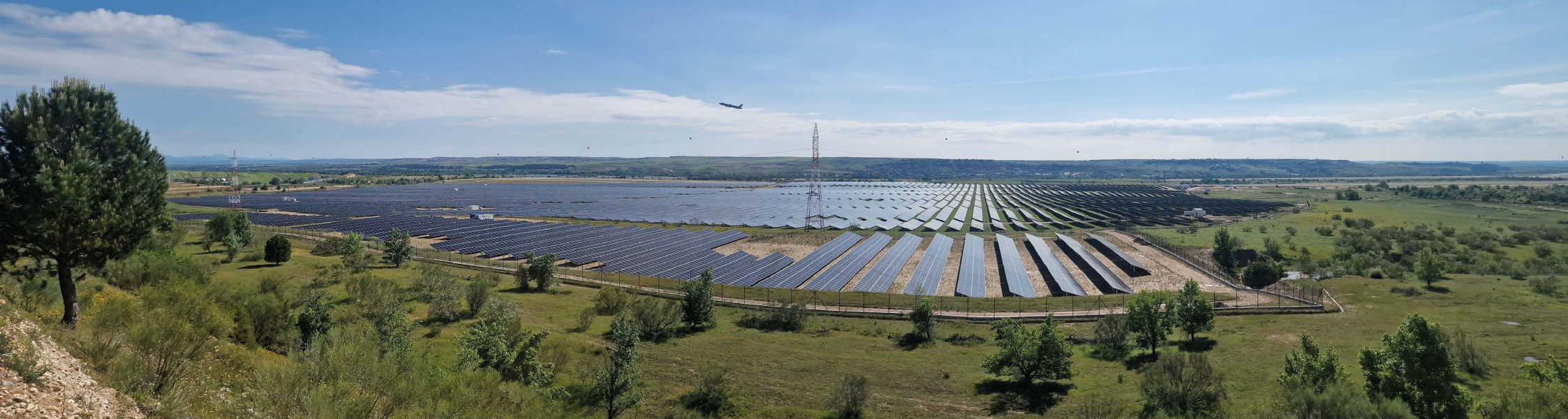
PLANTA SOLAR DEL AEROPUERTO INTERNACIONAL ADOLFO SUÁREZ MADRID - BARAJAS. 142,42 MW (ESPAÑA)
